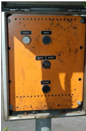
Betjeningskasse ved Nordkajen.
