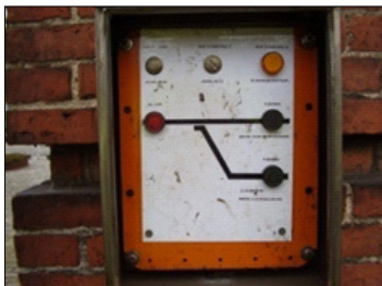
Betjeningskasse på husgavlen ved firmaet H. Daugaard.
