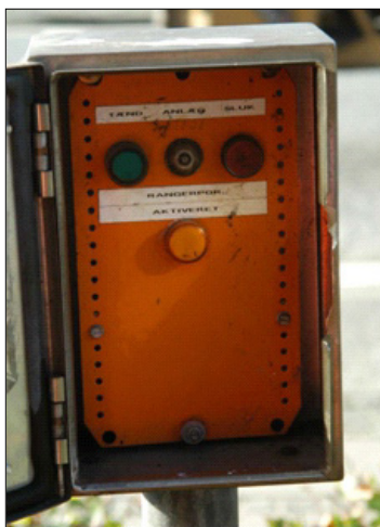
Betjeningskasse på stander på Casper Müllers Gade.
