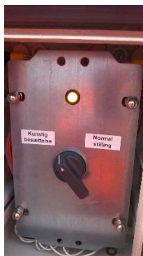
Stedlig dækning indkoblet:
