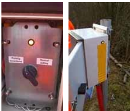
Stedlig dækning indkoblet
