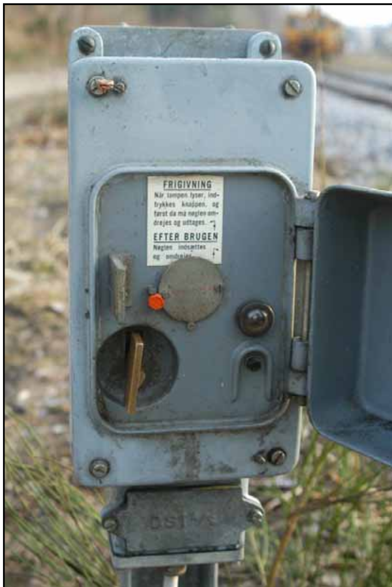
Skab med hovednøgle til elektromagnetisk nøglelåst sporskifte
