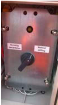
Stedlig dækning udkoblet:
