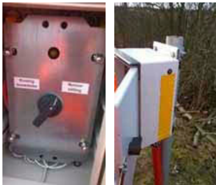
Stedlig dækning udkoblet
