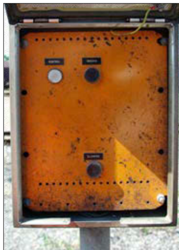
Betjeningskasse ved Jens Holms Vej.
