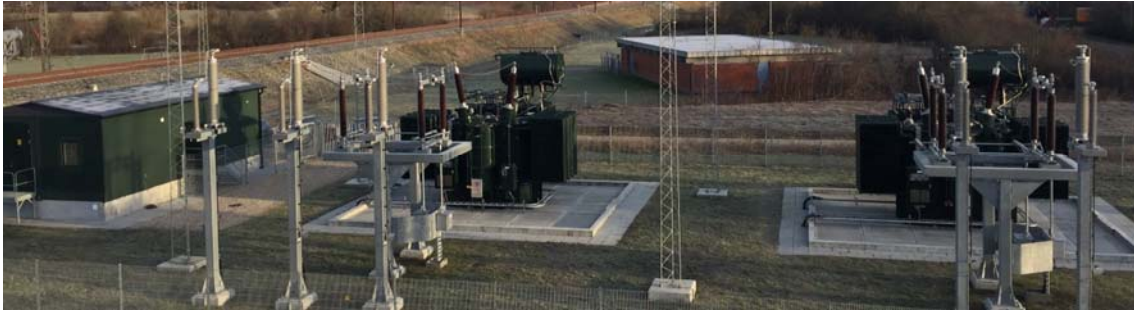
Figur 4 – Kildebrønde transformerstation [2 x 60 MVA]. Ny bane København-Ringsted
