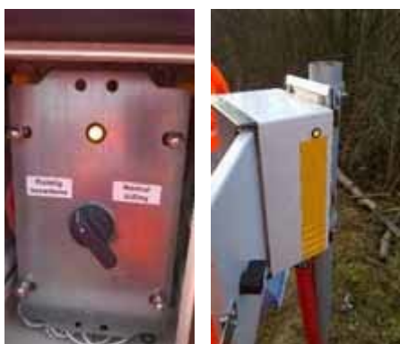
Stedlig dækning indkoblet
