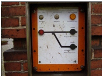
Betjeningskasse på husgavlen ved firmaet H. Daugaard.
