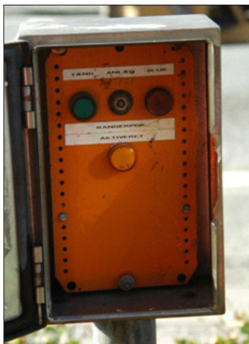
Betjeningskasse på stander på Casper Müllers Gade.
