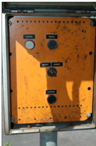
Betjeningskasse ved Nordkajen.
